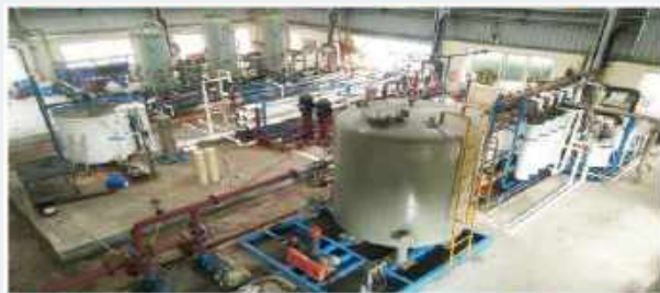
Effluent Treatment Plants (ETP)
