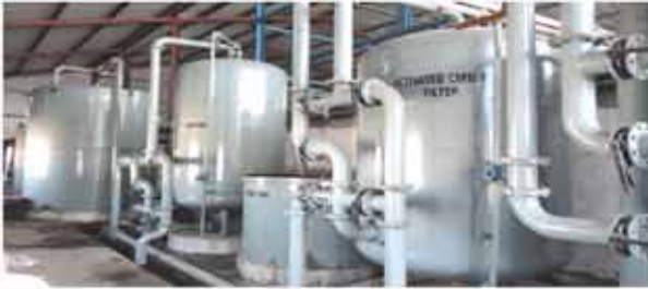
Reverse Osmosis Systems (ROS)
