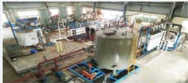
Effluent Treatment Plants (ETP)
